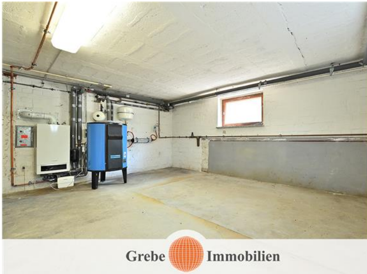
Heizung im Keller
